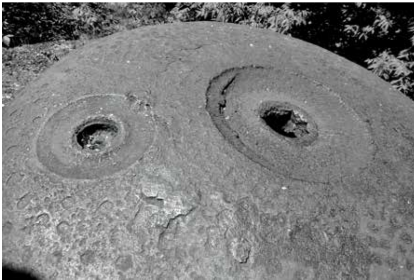
Kopuła pancerna tego schronu ze śladami użycia ładunków kumulacyjnych (po lewej 12,5kg, po prawej 50kg)
