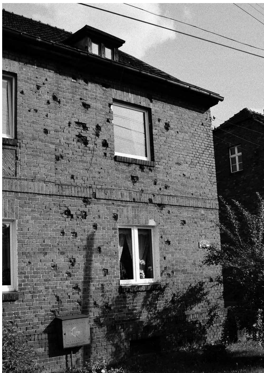
Ślady walk na budynku mieszkalnym w Górnikach
